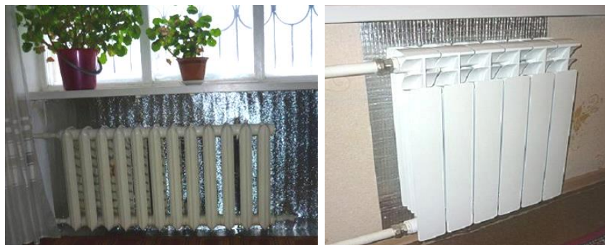
Рисунок 9. Отражающая теплоизоляция, установленная за радиатором отопления
